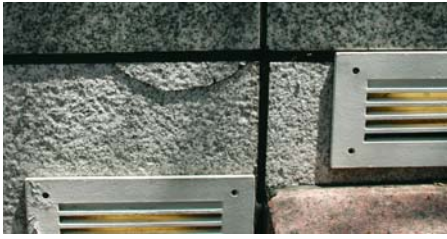
above Anchor failure due to ettringite.
